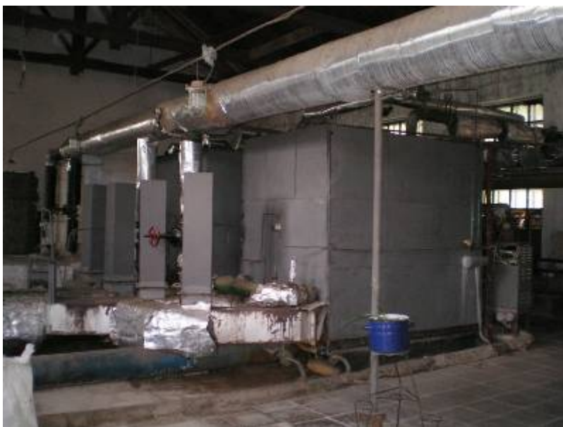
Котельні установки з I по IV
