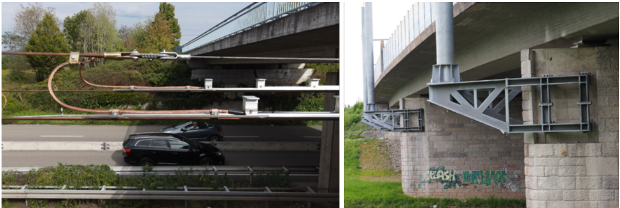
Abbildung 12: Oberleitung und Mastverankerung im Brückenbereich der B462 in Deutschland
